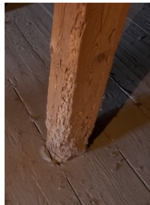
DETAIL PATY SLOUPU - DESTRUKCE DŘEVNÍ HMOTY
